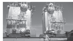
「機関室の取り扱いには苦労もあるが、やりがいのある仕事」(船用ボイラーの前で)
